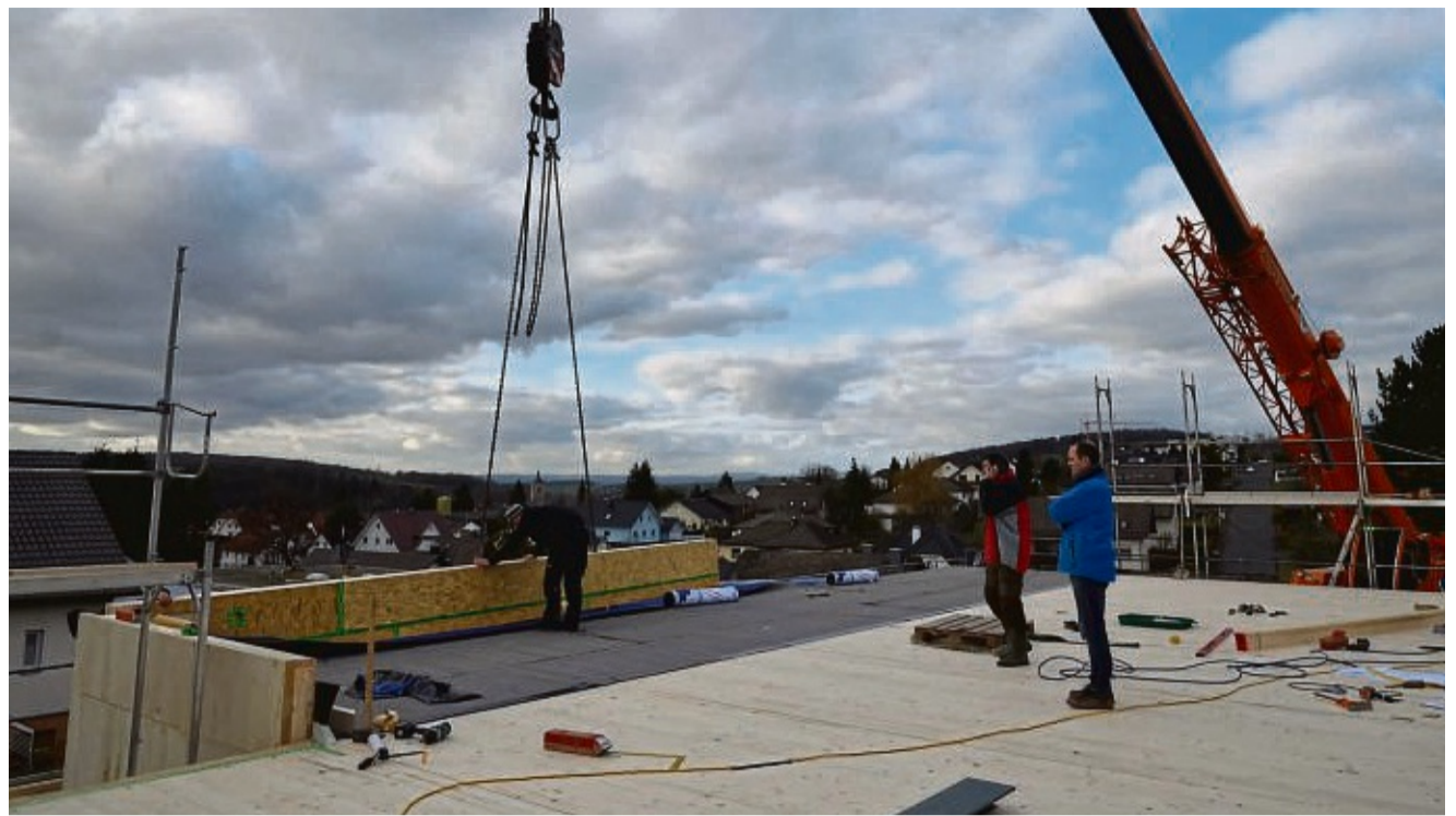
Wandelement am Haken: Achim Vogelsberg rechts beobachtet die Montage in der ersten Etage seines neuen Hauses, auf dem Fussboden sichtbar Brettsperrholz.
